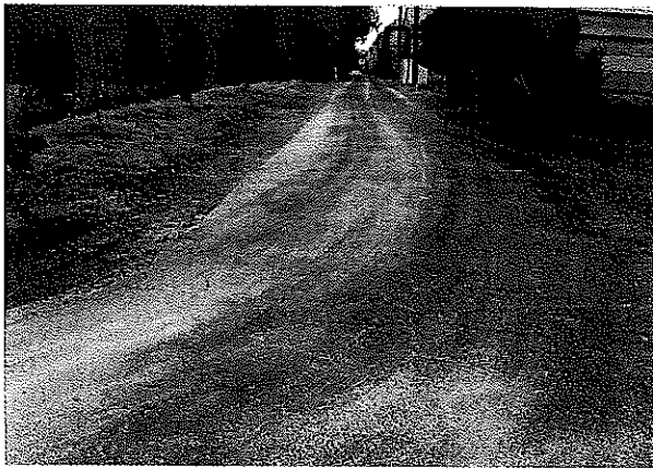
消石灰散布後の降雨、車両の通行等により石灰面は流出、剥離しやすい
